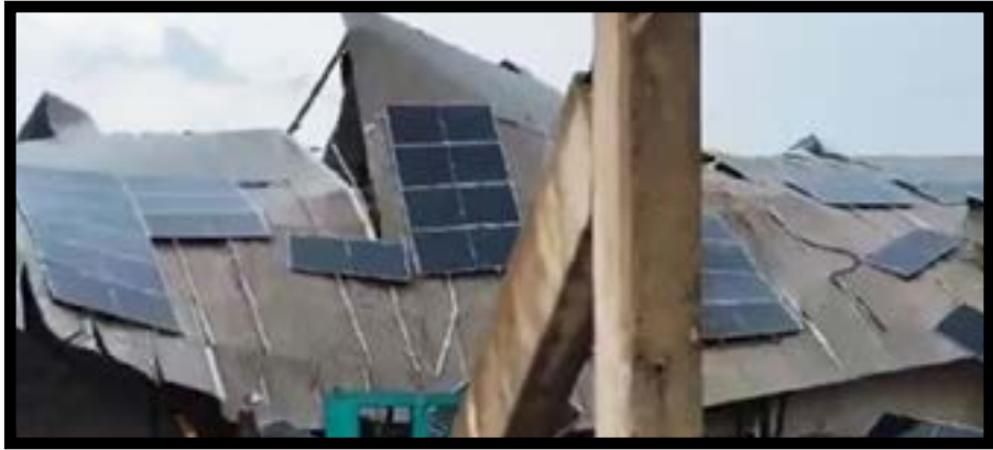
Um temporal causou vários estragos em Juara, na tarde de terça. Um barracão de 1,2 mil m² teve a estrutura danificada e o teto desabou. Imagens registradas mostram pilares quebrados e o telhado totalmente destruído. Barracões vizinhos também aparecem danificados. Um barracão localizado na estrada Maria Adelina ficou parcialmente destelhado. Também há registros de danos na escola Oscar Soares e queda de árvores pela cidade. Até o momento, não há informações de feridos. Segundo o Instituto Nacional de Meteorologia (Inmet), a previsão para Juara, hoje à noite e amanhã, é de muitas nuvens, com possibilidade de chuva isolada. A mínima prevista é de 23 graus e máxima de 37. Também choveu esta tarde em Sinop, Sorriso e Nova Mutum. Em Sinop, na região central choveu por menos de 30 minutos.
